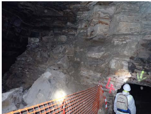
Figure 11 : Pilier partiellement effondré
