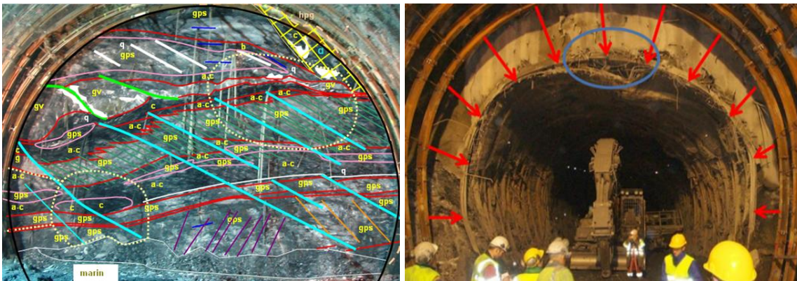
49 50 Figure 2. Hétérogénéité de matériaux au front de taille et ovalisation de la section observées dans 51 les galeries de SMP.
