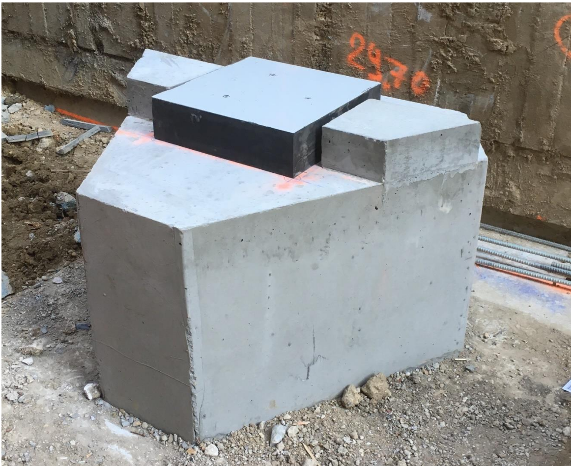
Figure 8. Massif inférieur en béton armé surplombé de son appareil d'appui (Massif B)
