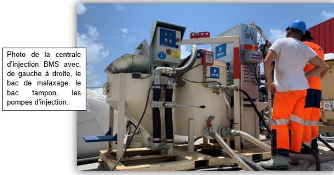
Figure 1 : exemple de centrale d'injection pour une injection par imprégnation.
